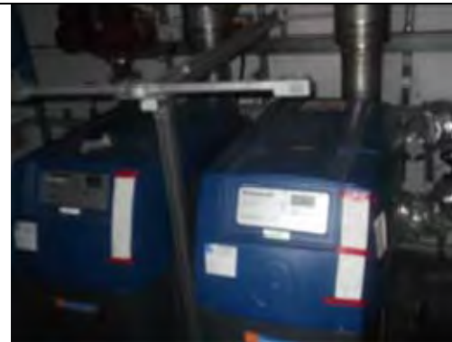
Modern non ACM boilers
