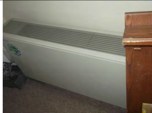
Modern non ACM heater
