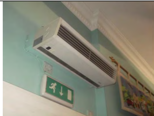
Modern non ACM heater
