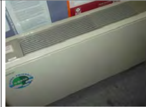
Modern non ACM heater
