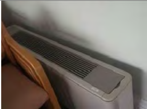
Modern non ACM heater
