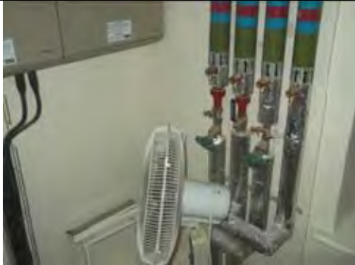
MMMMF and foil wrap to pipes. Non ACM
