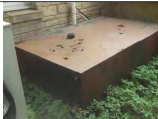
Modern non ACM tank
