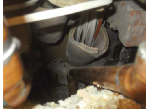
Non ACM pipes
