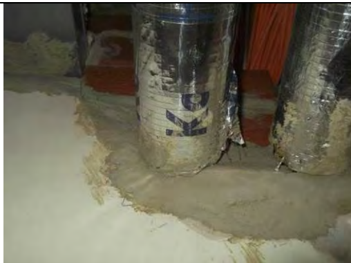
Modern non ACM lagged pipes
