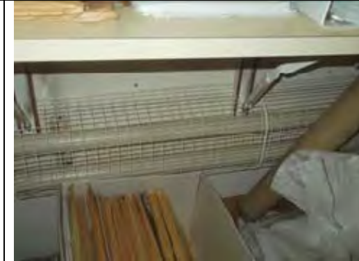
Modern non ACM heater
