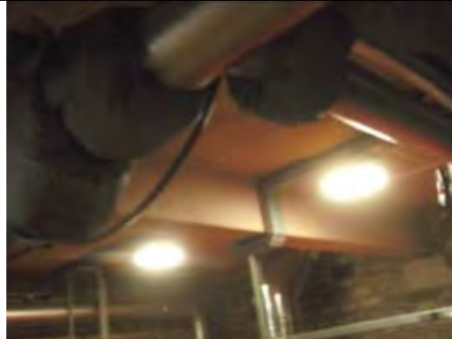
Modern non ACM pipes
