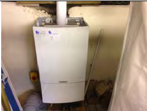
Modern non ACM boiler
